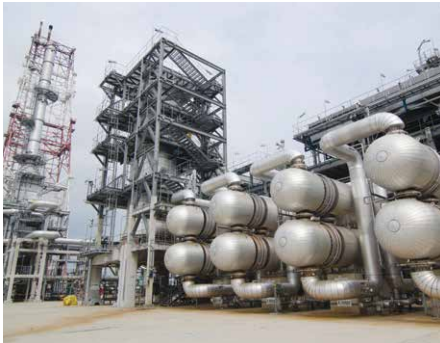
Hijau Unit - A diesel hydrodesulphurisation unit.
