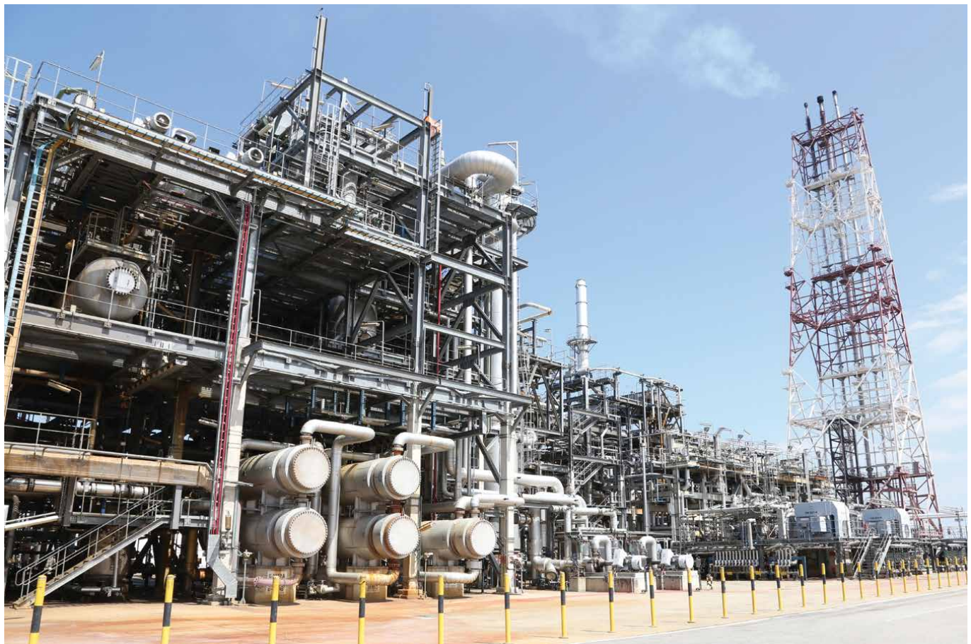
Hijau Unit - A diesel hydrodesulphurisation unit.
